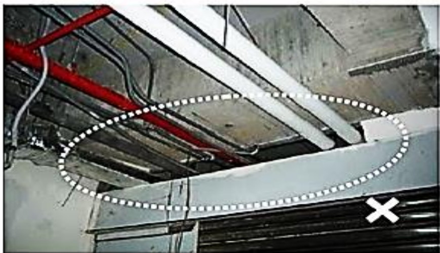
▲ 防火區劃不完整案例（自動防火捲門頂部配線貫穿部未填塞）。
