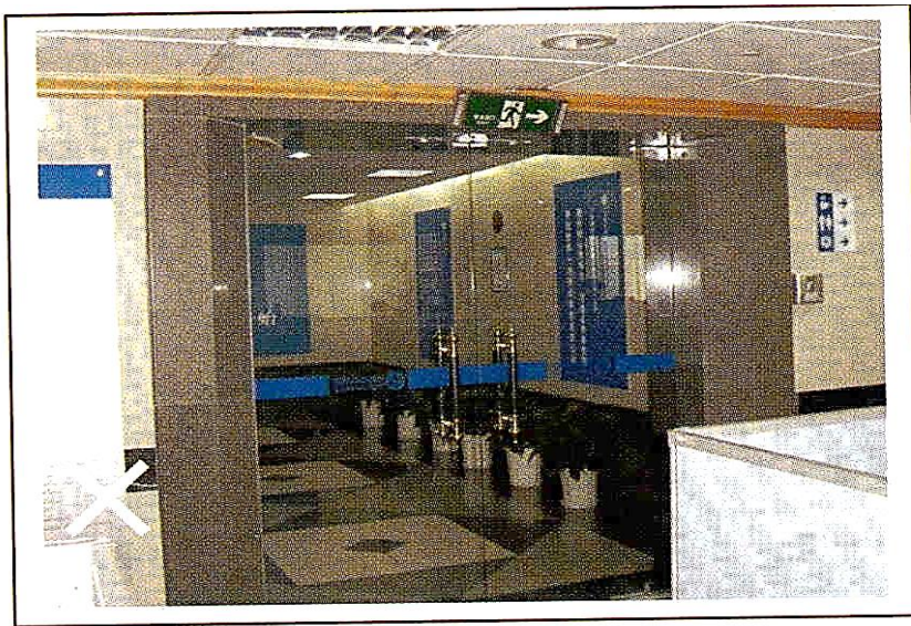
▲ 將防火門擅自更改為玻璃門，形同破壞防火區劃。
