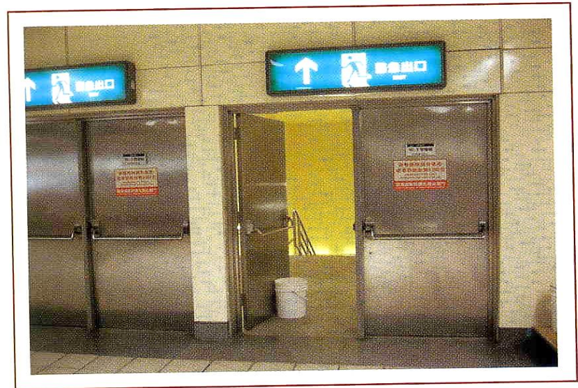
▲ 常時關閉式防火門案例，該類門扇應免用鑰匙即可開啓，且不得設置門止。
